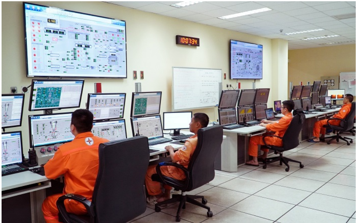
Lực lượng vận hành tại Nhà điều khiển trung tâm Công ty Nhiệt điện Thái Bình
