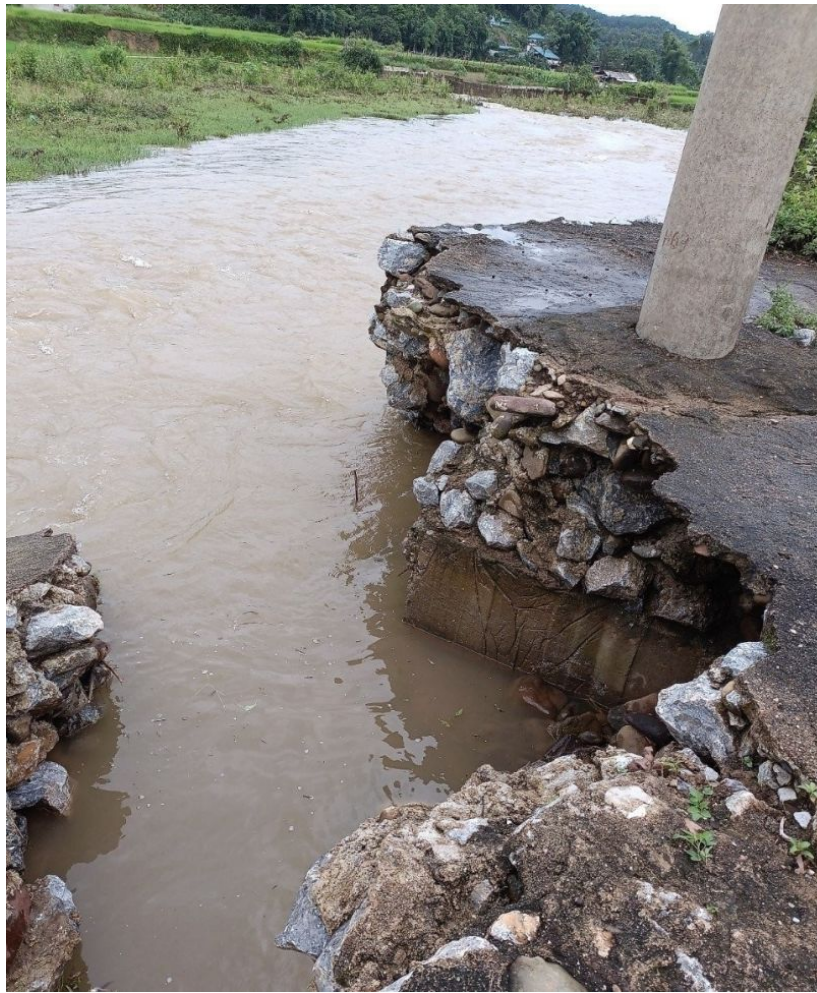
Vị trí cột 45 ĐZ 35kV lộ 375 E21.2 khu vực Lai Châu
