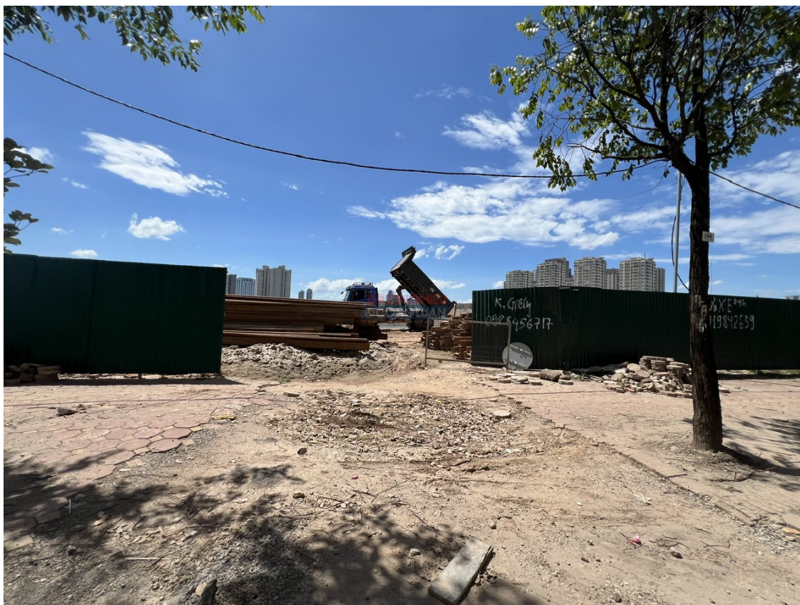
Đoàn rào chắn thị công trên đường Tố Hữu sơ sài, không được bao kín khu vực xây dựng
