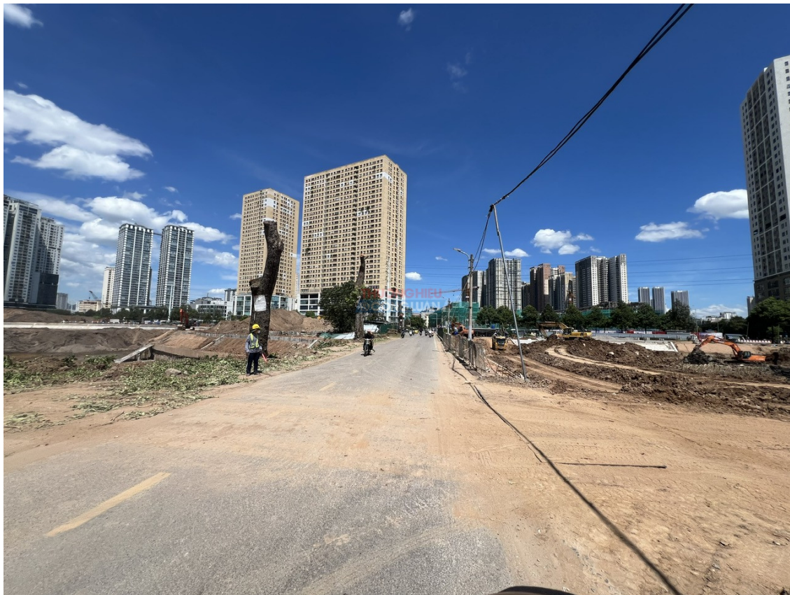
Đất cát rơi vãi nhiều trên đường và xung quanh công trình
