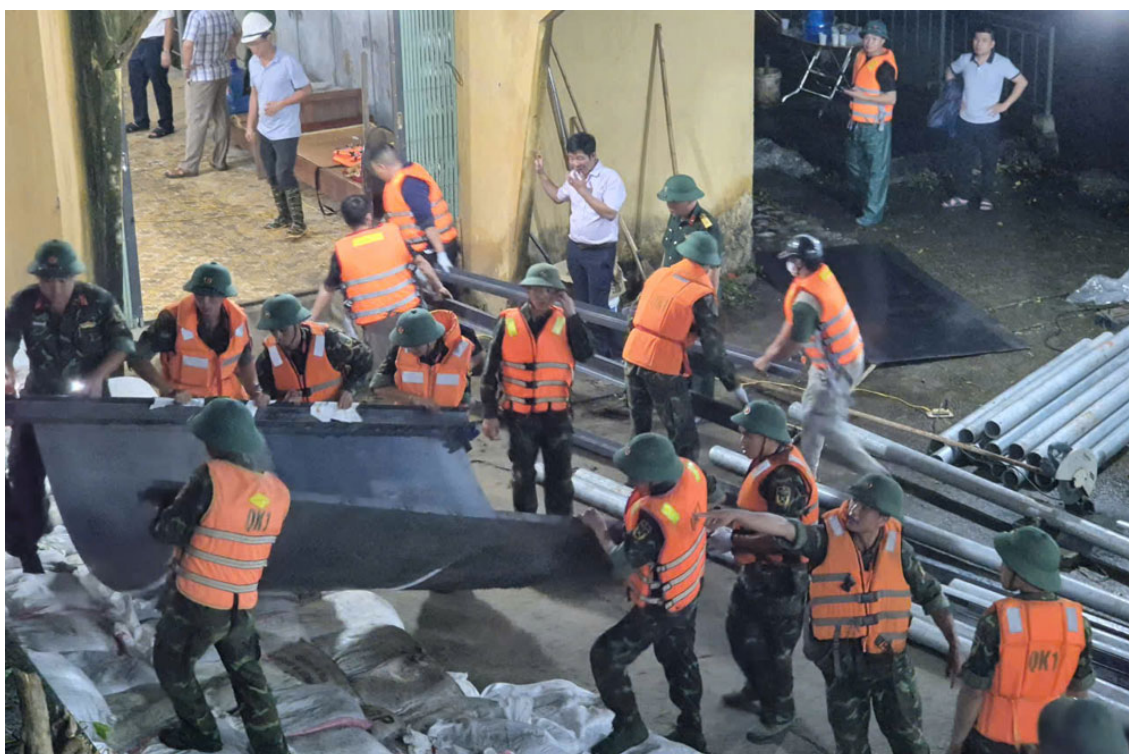
Lực lượng chức năng xử lý sự cố Trạm bơm Cống Bún
