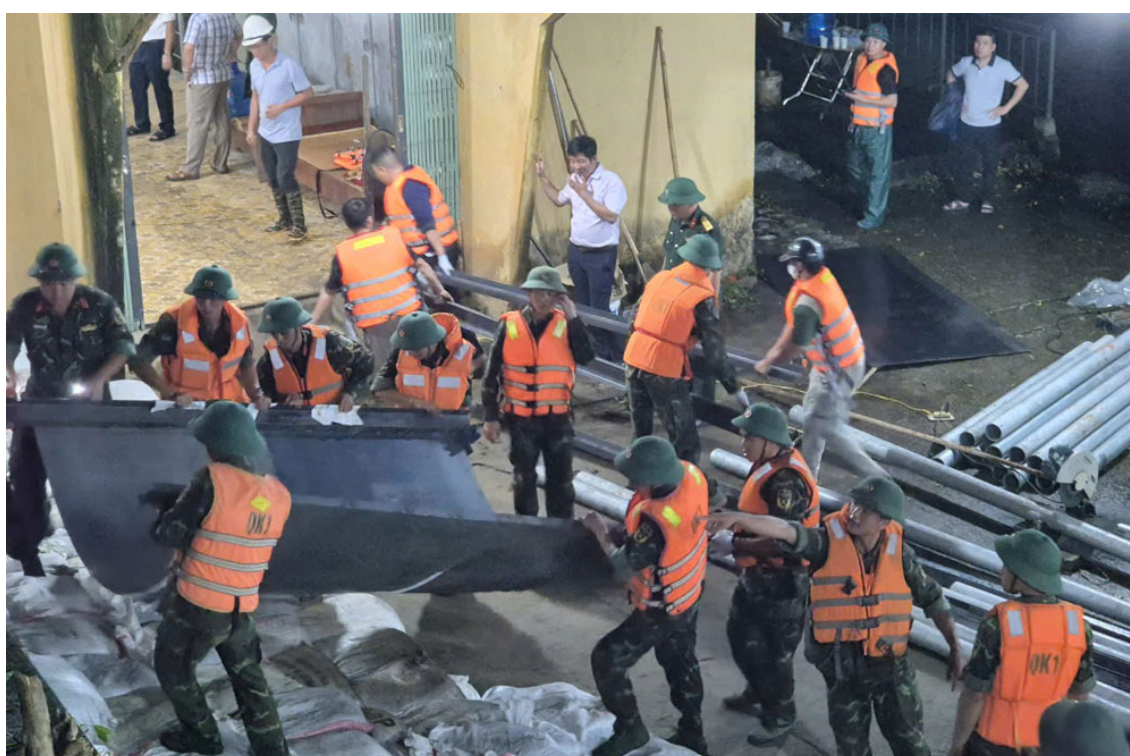
Cán bộ, chiến sĩ lực lượng vũ trang được huy động đến xử lý sự cố Trạm bơm Cống Bún.
