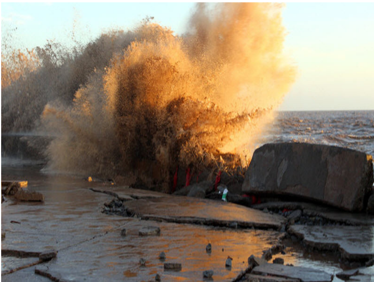
Một đoạn kè Gành Hào bị sóng đánh vỡ (Ảnh: TTO)
