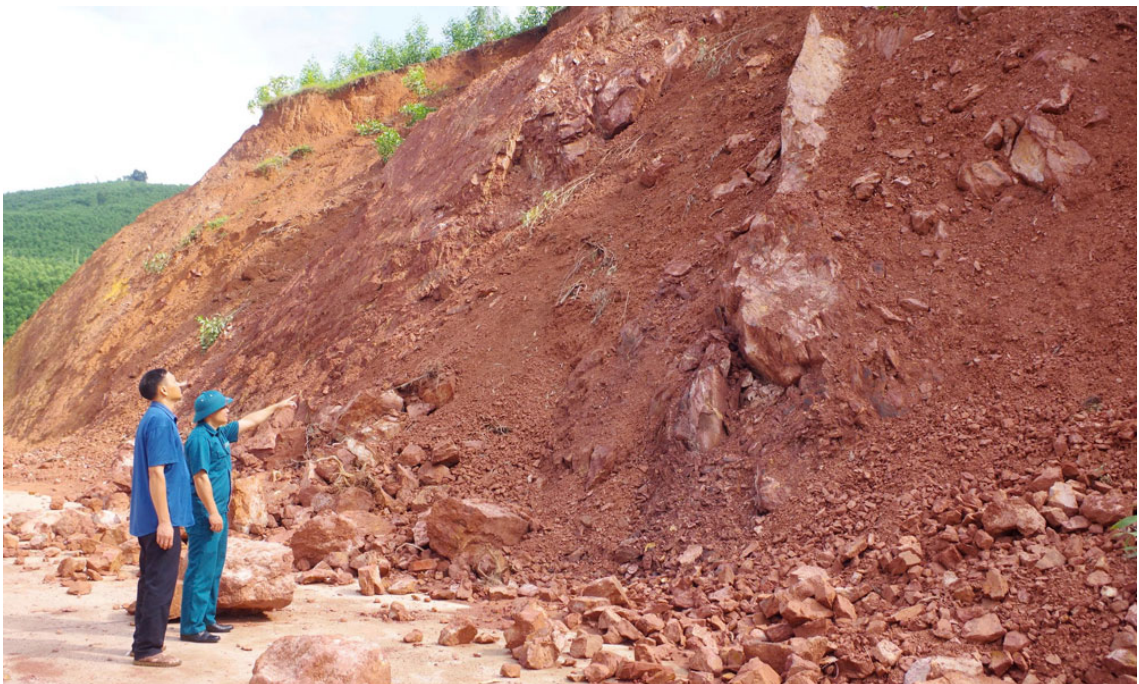
Ban Chỉ huy Quân sự xã An Lạc kiểm tra tuyến đường thường xuyên xảy ra sạt lở đất.
