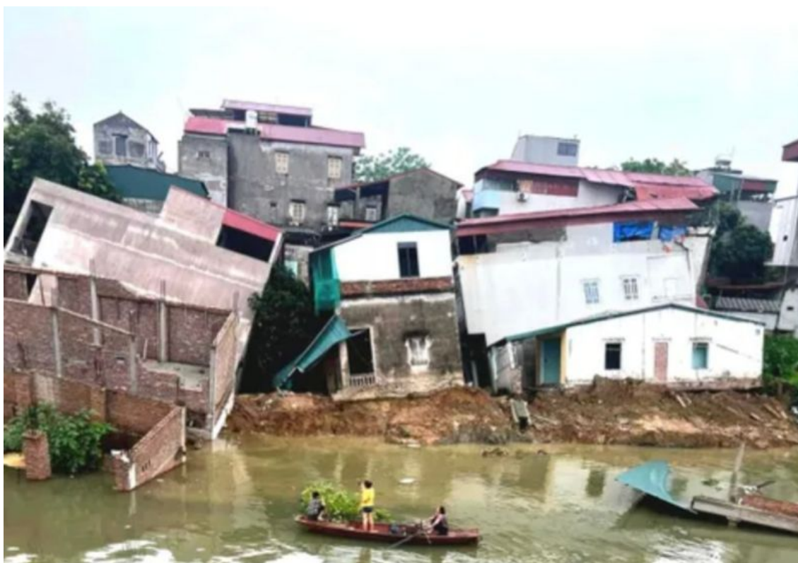
Đê Sông cầu khu Vạn Phúc, phường Vạn An, TP. Bắc Ninh, nơi 6 ngôi nhà bị lún xuống sông.
