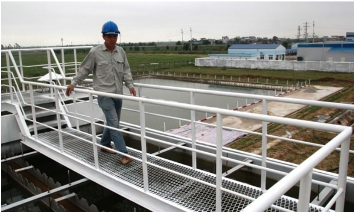
Hệ thống xử lý nước thải KCN Quế Võ 2
