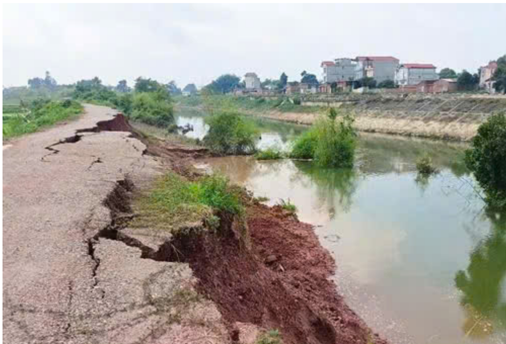
Đê bồi ở xã Mỹ Thái bị sạt lở.
