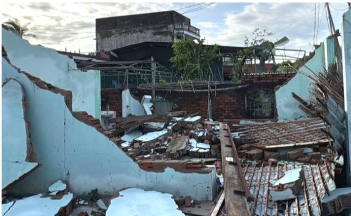
Nhiều ngôi nhà bị sập hoàn toàn sau khi bão số 13 đổ bộ
