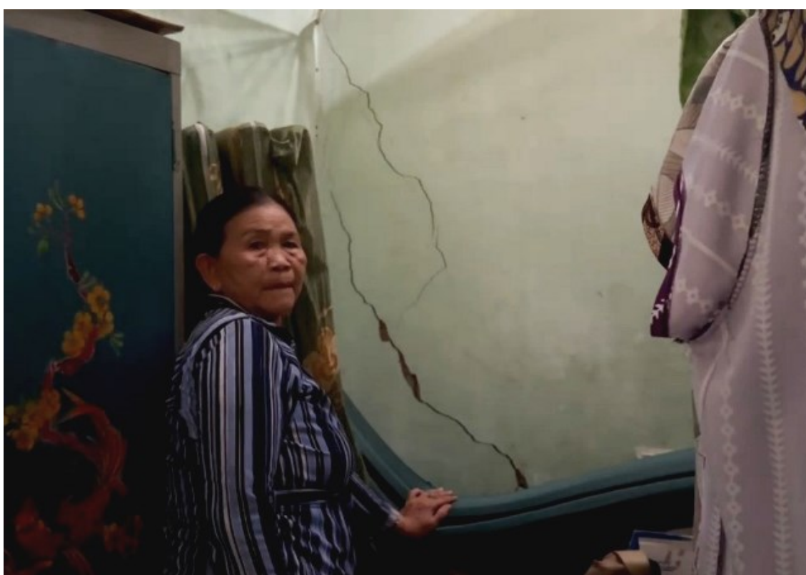
Nhà người dân nằm trên mặt đường Quốc lộ 19 ảnh hưởng dự án đã xuất hiện những vết tường bị nứt
