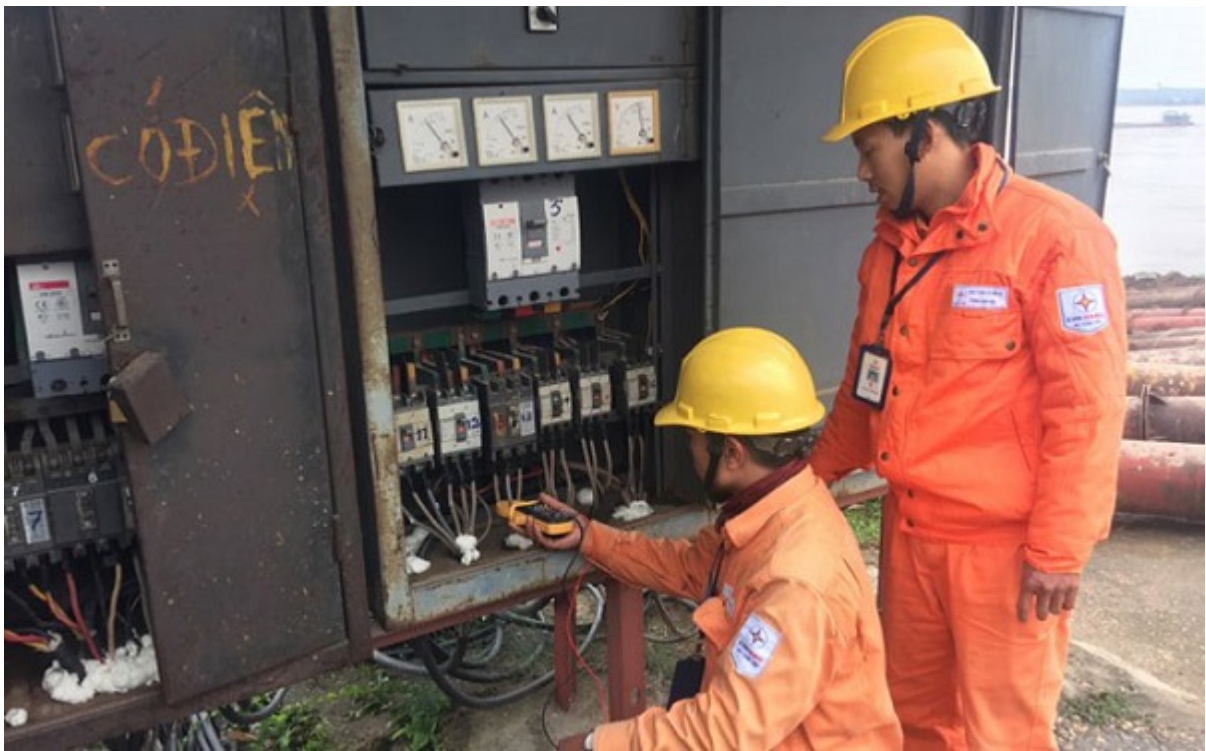
Công nhân EVN Hà Nội đo thông số vận hành tại trạm biến áp trên Bờ Hồ
