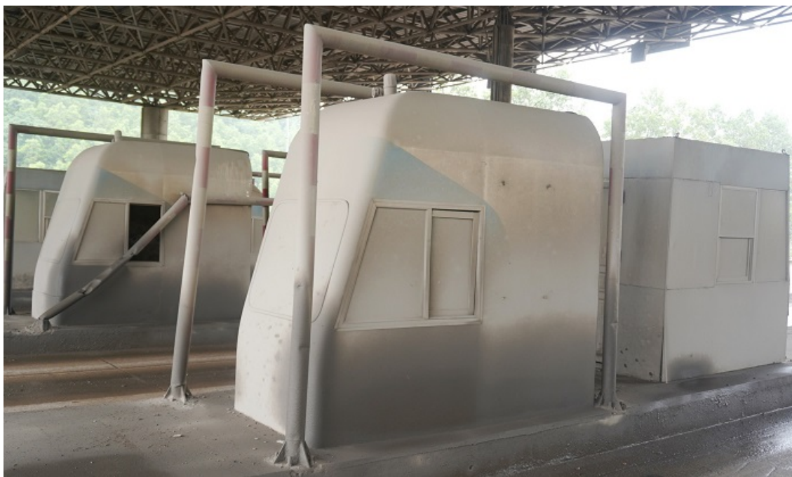
Hệ thống cabin thu phí bỏ hoang, xuống cấp.
