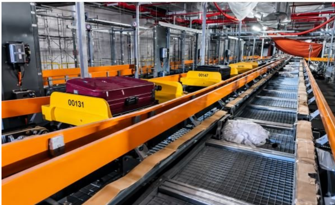
Hệ thống xử lý hành lý tự động
