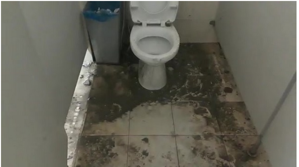
Nhà vệ sinh chứa đầy cát và nước bẩn, thoáng nhìn vào, nhiều người sẽ lầm tưởng đây là nhà vệ sinh tại các công trường xây dựng
