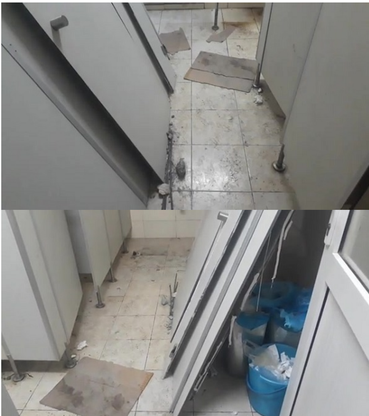
Các vật dụng vứt bừa bãi, nhếch nhác bên trong khu nhà vệ sinh
