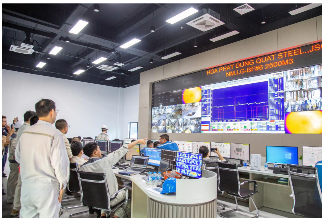
Đội ngũ kỹ sư Nhà máy luyện gang kiểm soát các thông số kỹ thuật của lò cao tại phòng điều khiển trung tâm. Ảnh: HPG
