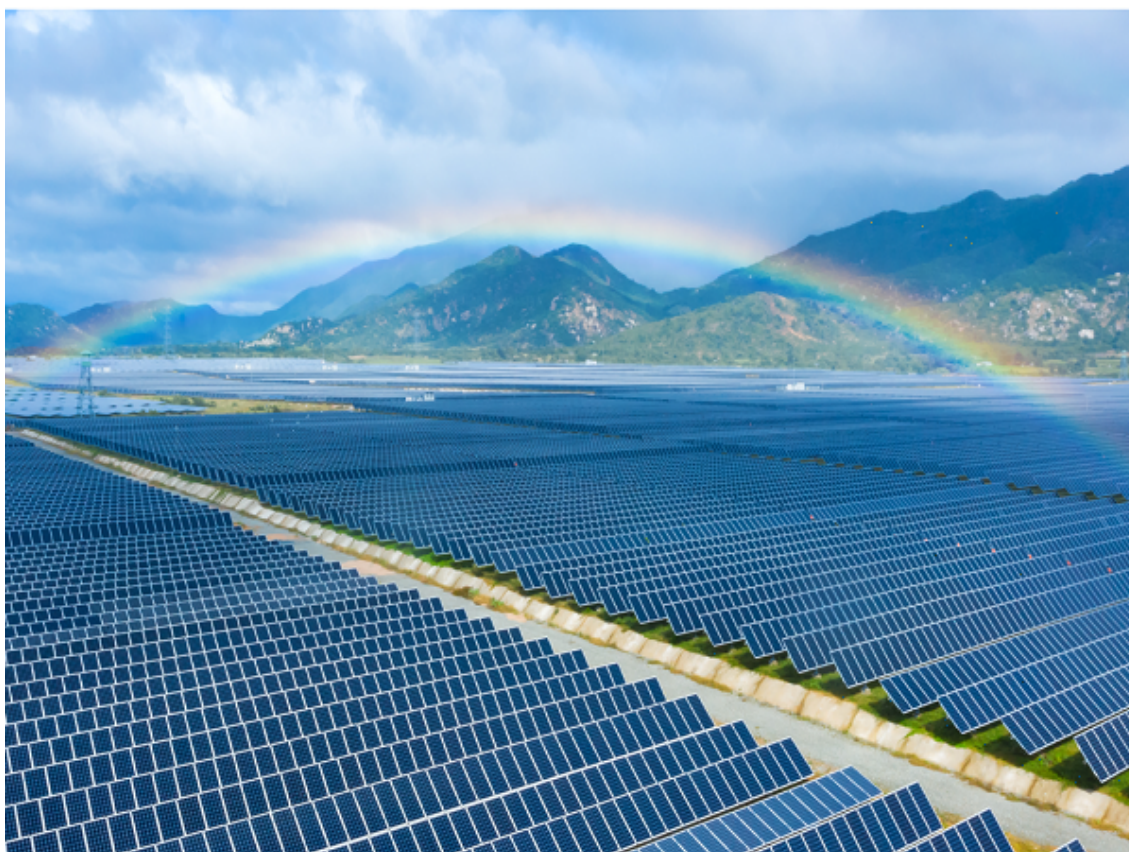
Dự án Nhà máy điện mặt trời Trung Nam tại huyện Thuận Bắc, tỉnh Ninh Thuận (Ảnh: TLCT)
