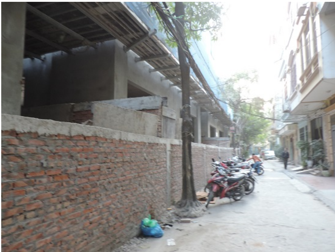
Nơi bị người dân tố cáo xây tường cao gần bằng tầng 1 nhà dân
