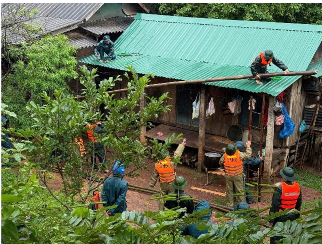
Lực lượng Công an xã giúp người dân gia cố lại nhà cửa. (Ảnh: Công an Quảng Trị)
