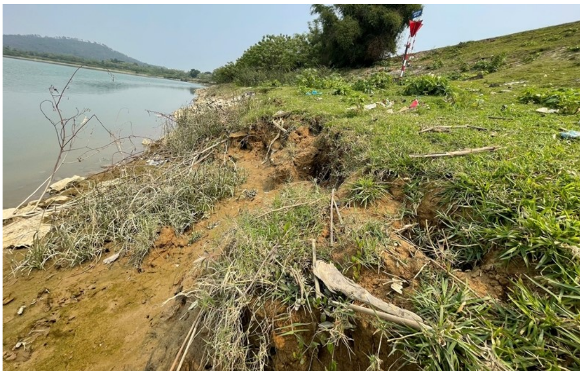
Công bố tình huống khẩn cấp sạt lở, hư hỏng kè Phú Văn
