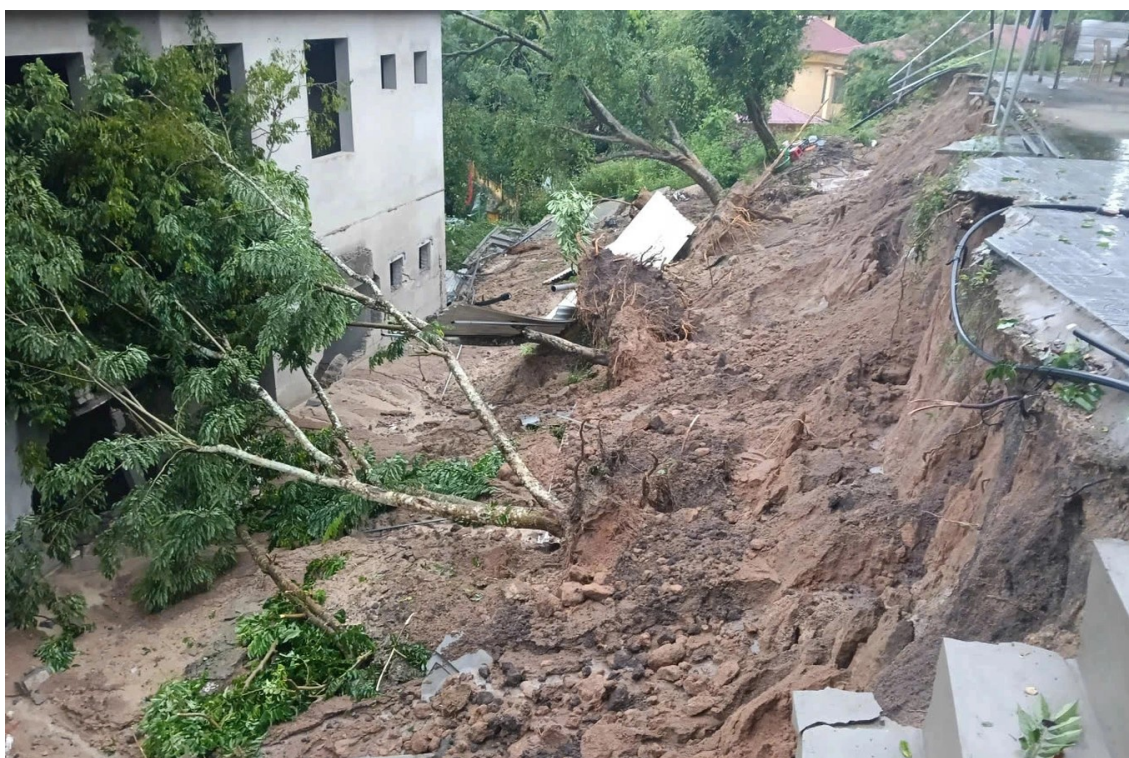
Tình trạng sạt lở tại dãy nhà 2 tầng đang xây dựng của Trường THCS Dân tộc bán trú Mường Lý (Ảnh: Vi Hùng)
