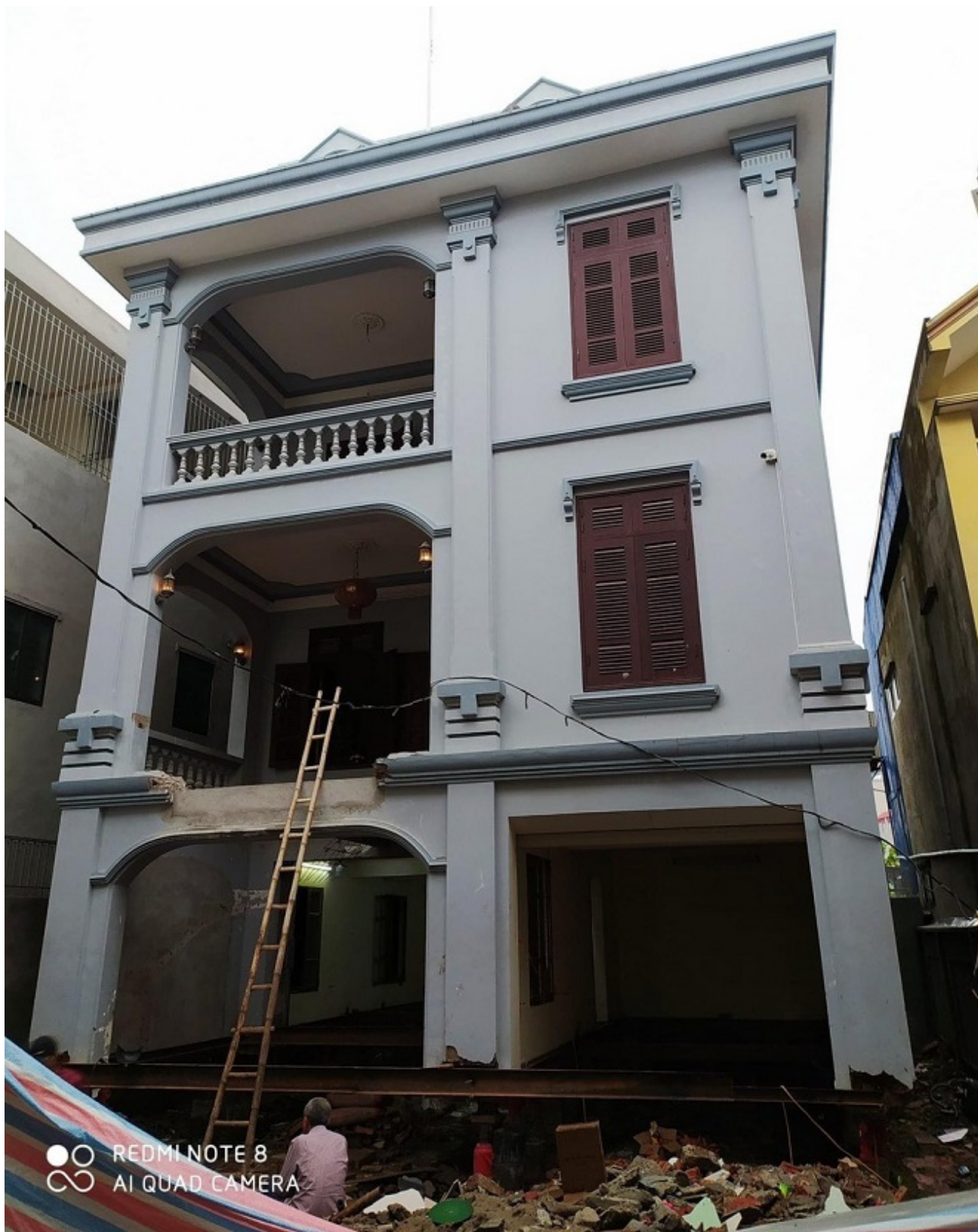
Công trình bị lún, nghiêng tại tỉnh Nam Định được VNSS xử lý thành công
