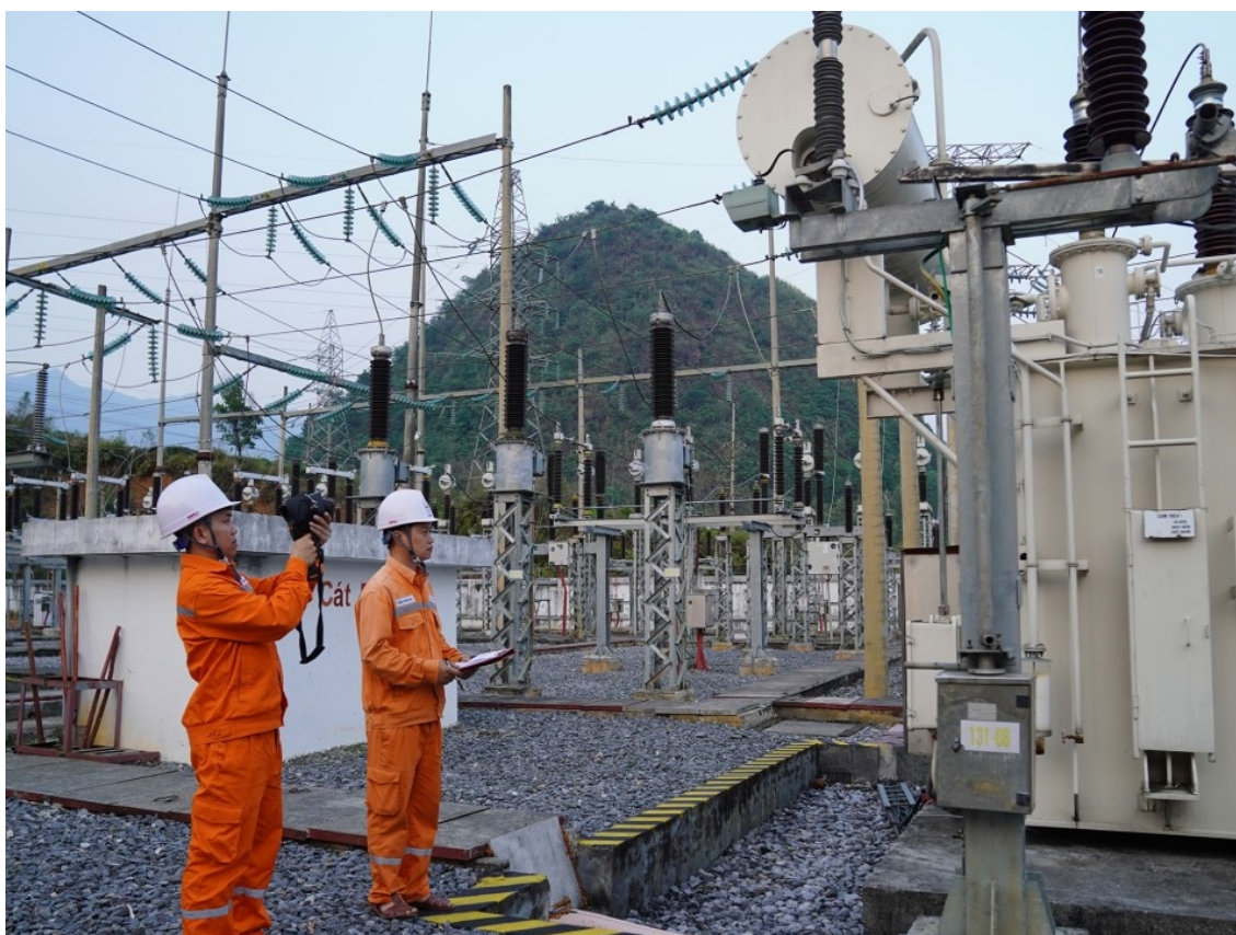
Xí nghiệp lưới điện cao thế Lai Châu kiểm tra vận hành trạm 110 kV bằng Camera nhiệt
