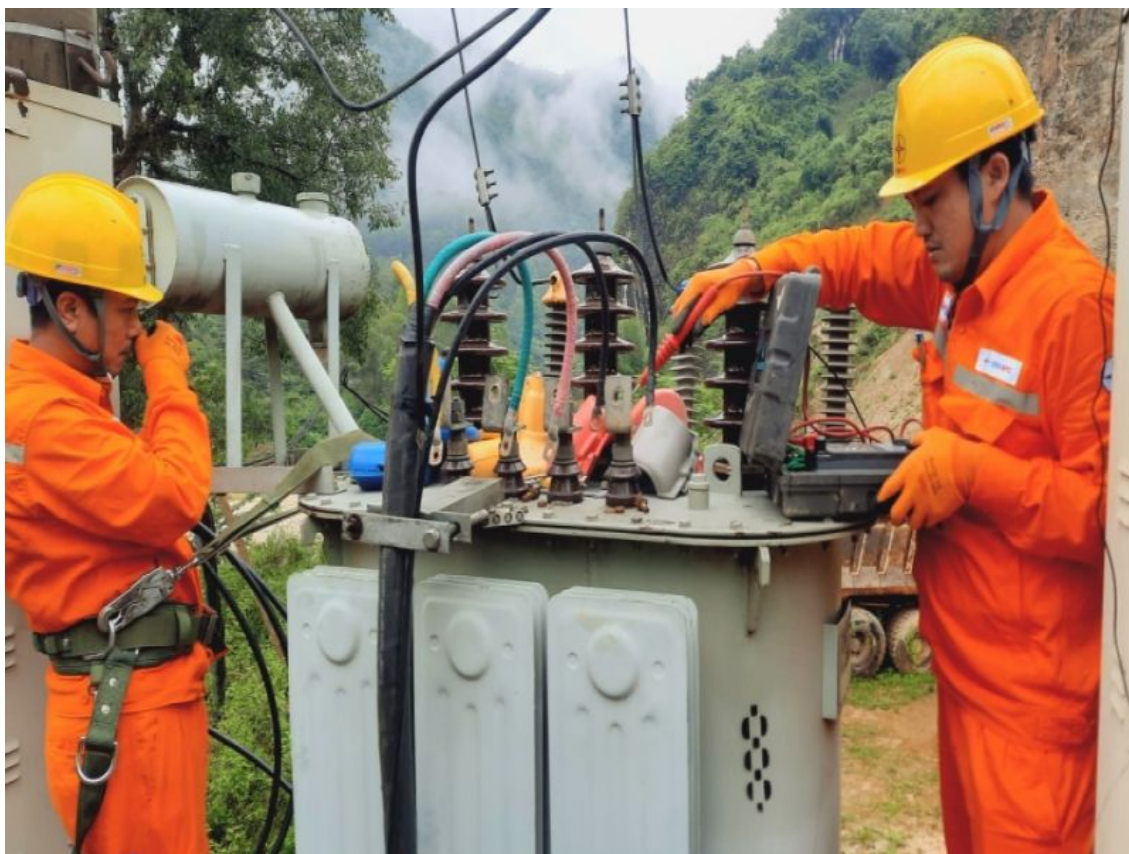
Công nhân đội Quản lý vận hành lưới điện cao thế Lai Châu thí nghiệm TBA chuyên dùng.
