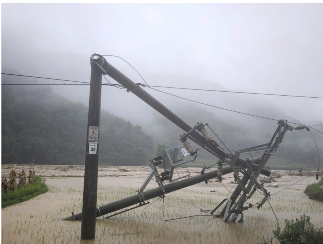
Mưa lũ gây gãy đổ cột điện trên địa bàn Điện lực Than Uyên quản lý
