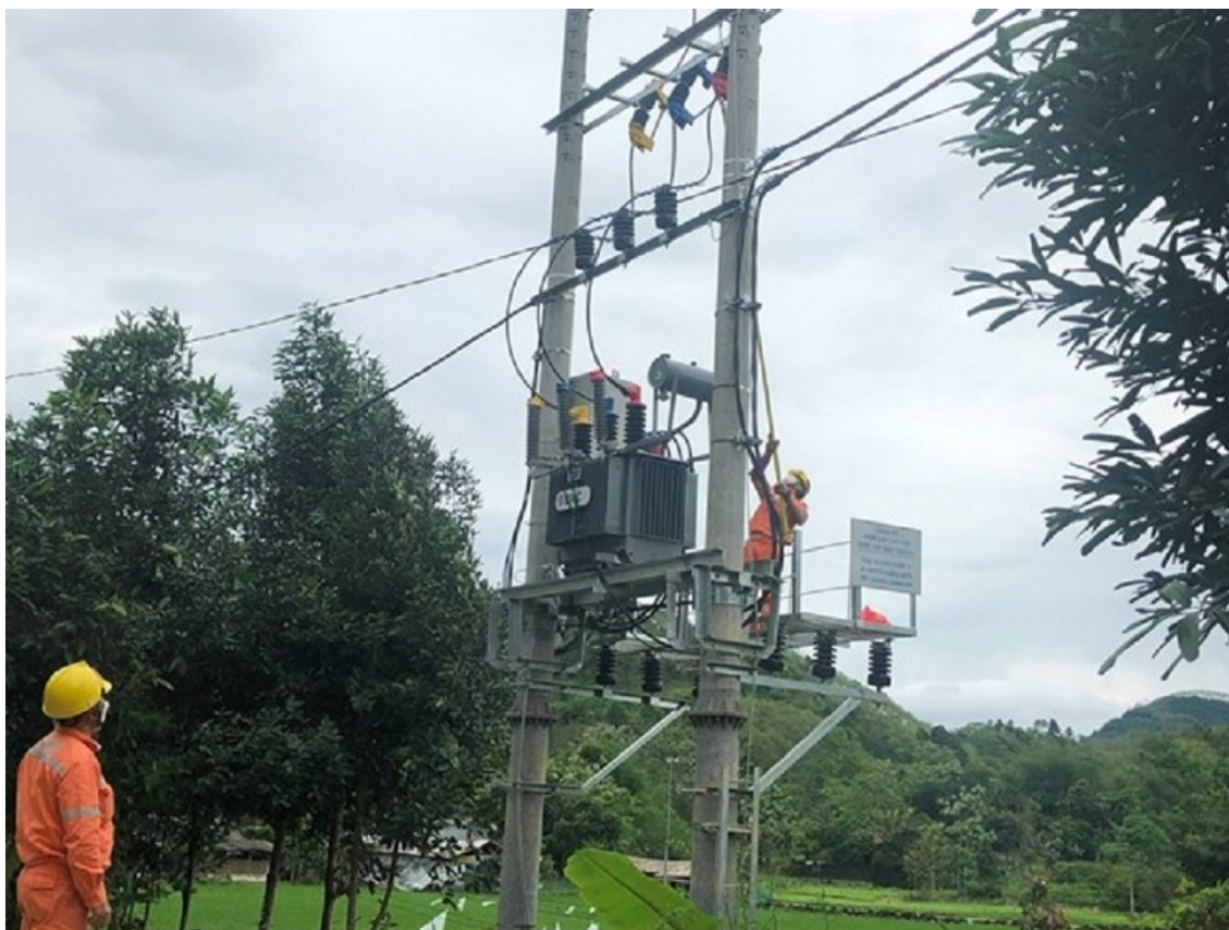
Đóng điện trạm biến áp Xuân Tiến.
