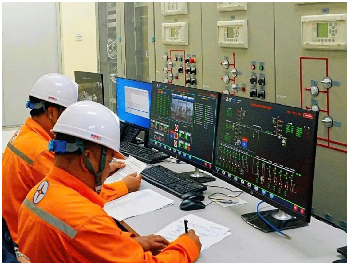
Nhân viên Xí nghiệp Lưới điện cao thế Quảng Ninh thực hiện công tác đóng điện TBA 110 kV Hoàn Bồ
