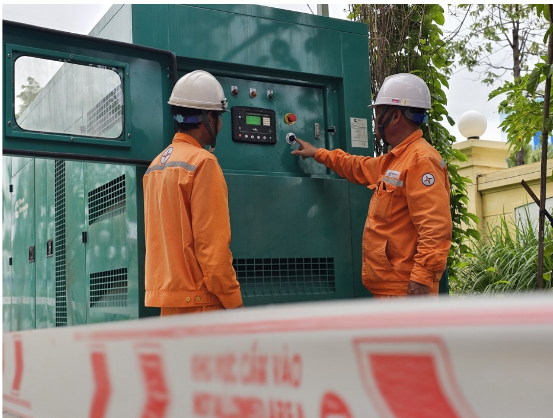
Điện lực Hạ Long kiểm tra máy phát điện tại điểm thi trường THPT Hòn Gai
