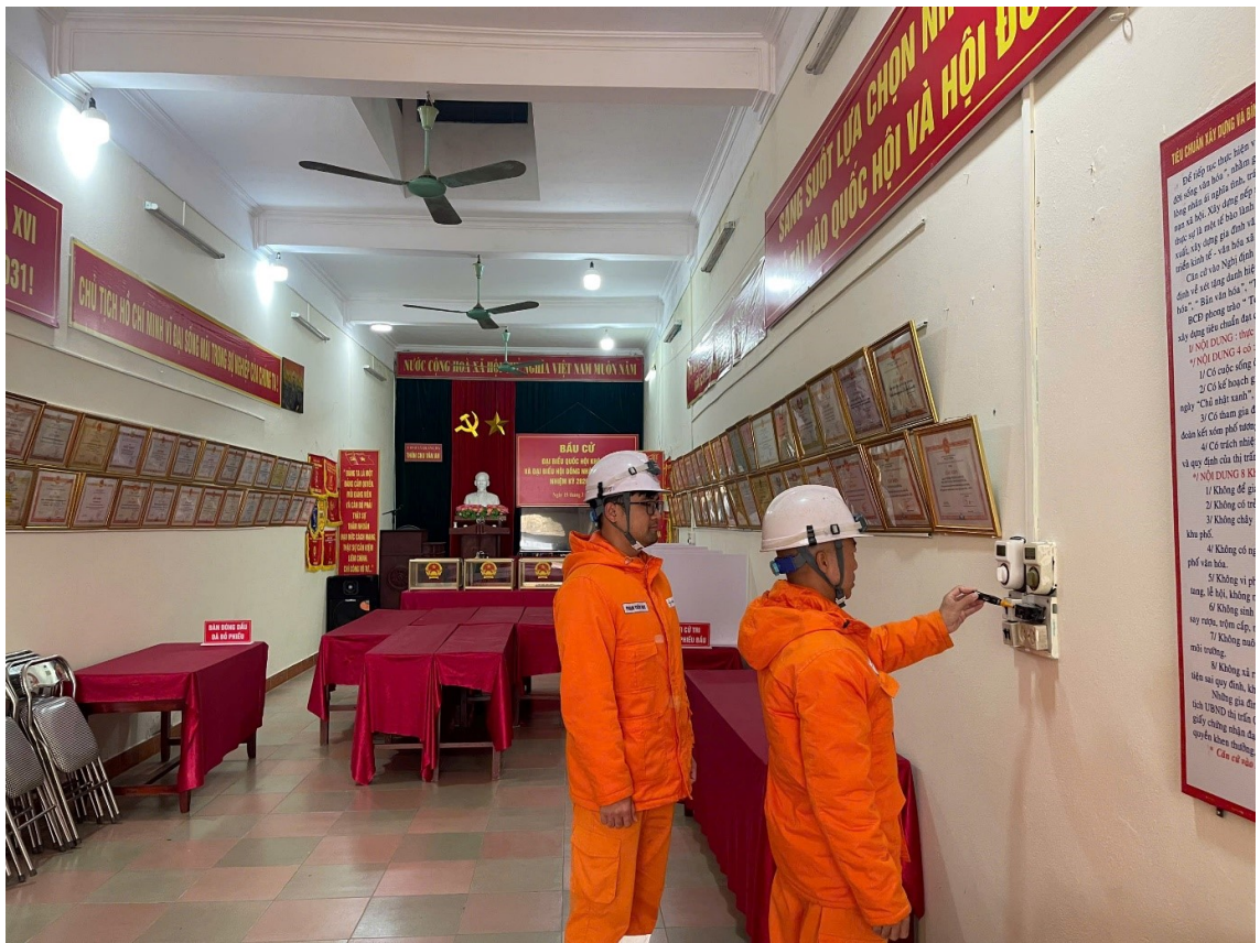
Nhân viên Đội QLĐLKV Hải Hà kiểm tra hệ thống điện tại địa điểm bầu cử
