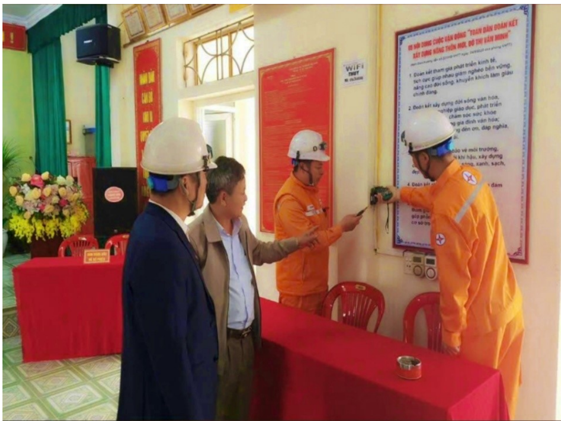
Nhân viên Đội QLĐLKV Móng Cái kiểm tra hệ thống điện địa điểm bầu cử
