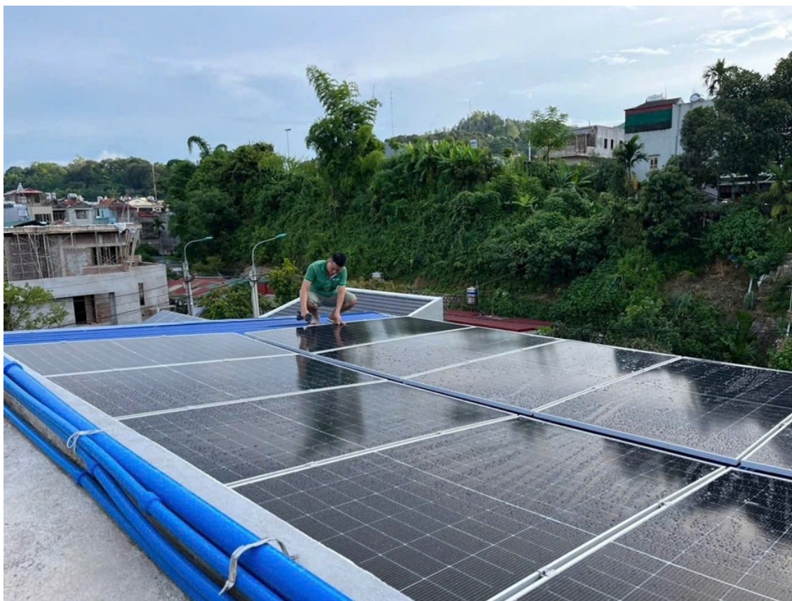
Hệ thống pin mặt trời mái nhà tại hộ gia đình
