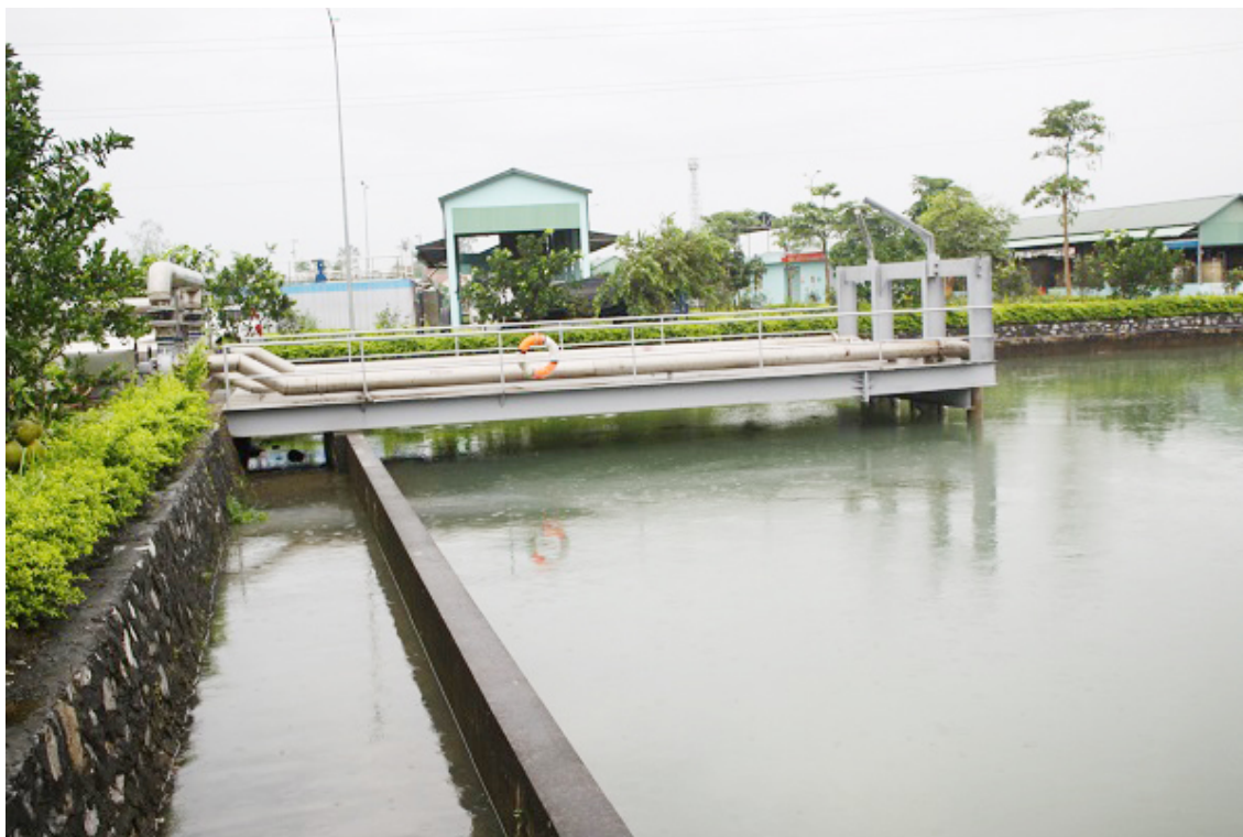
Hệ thống xử lý nước thải Công ty cổ phần Đầu tư phát triển Yên Bình
