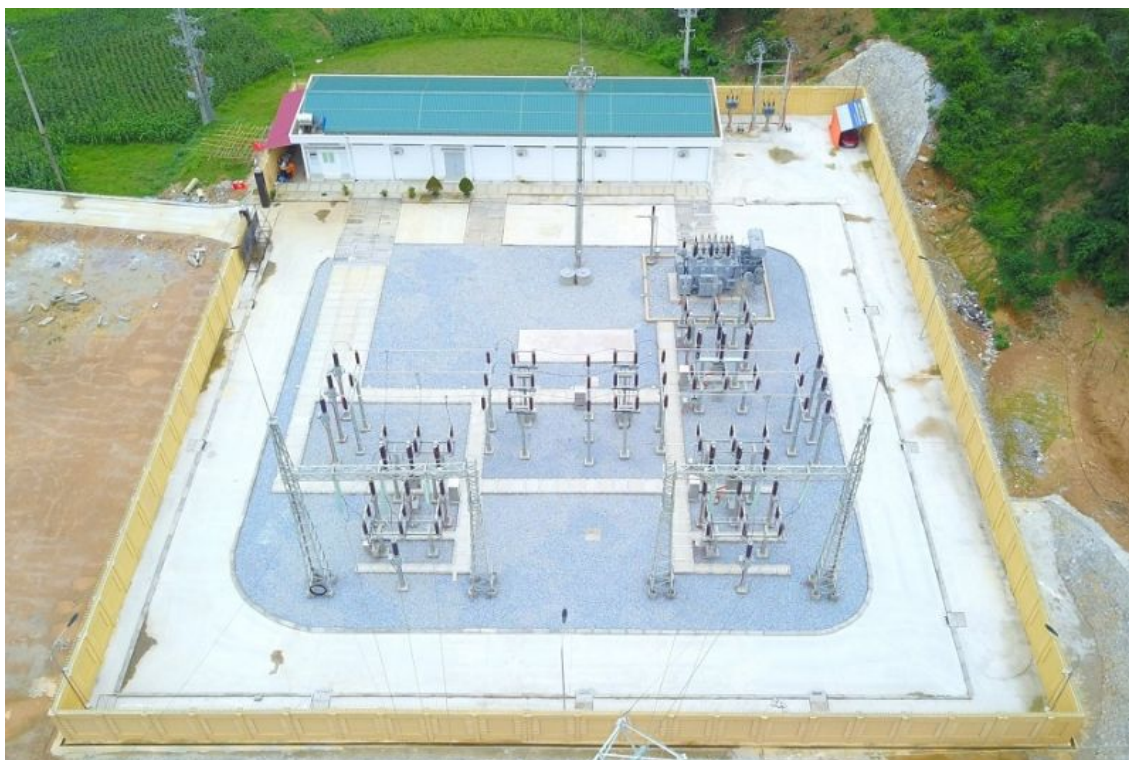
Trạm biến áp không người trực 110kV Na Hang đóng điện tháng 1/2023
