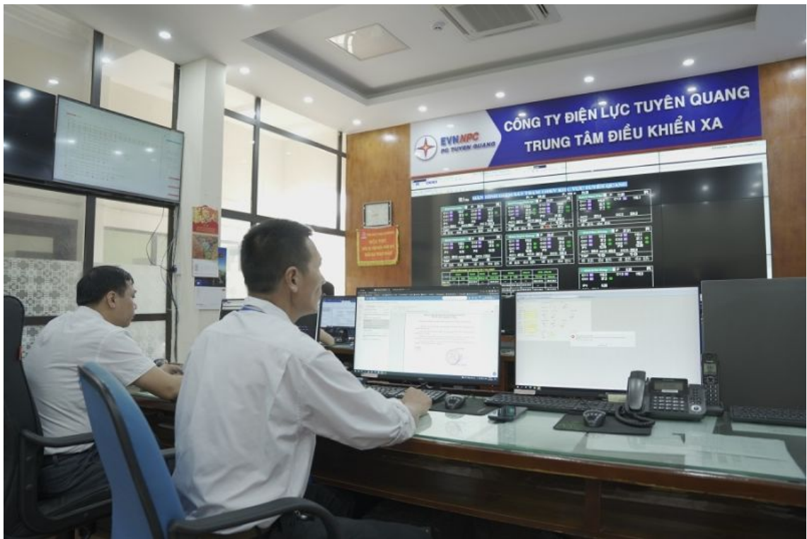
Các cán bộ, công nhân của Trung tâm Điều khiển xa Công ty Điện lực Tuyên Quang trực vận hành
