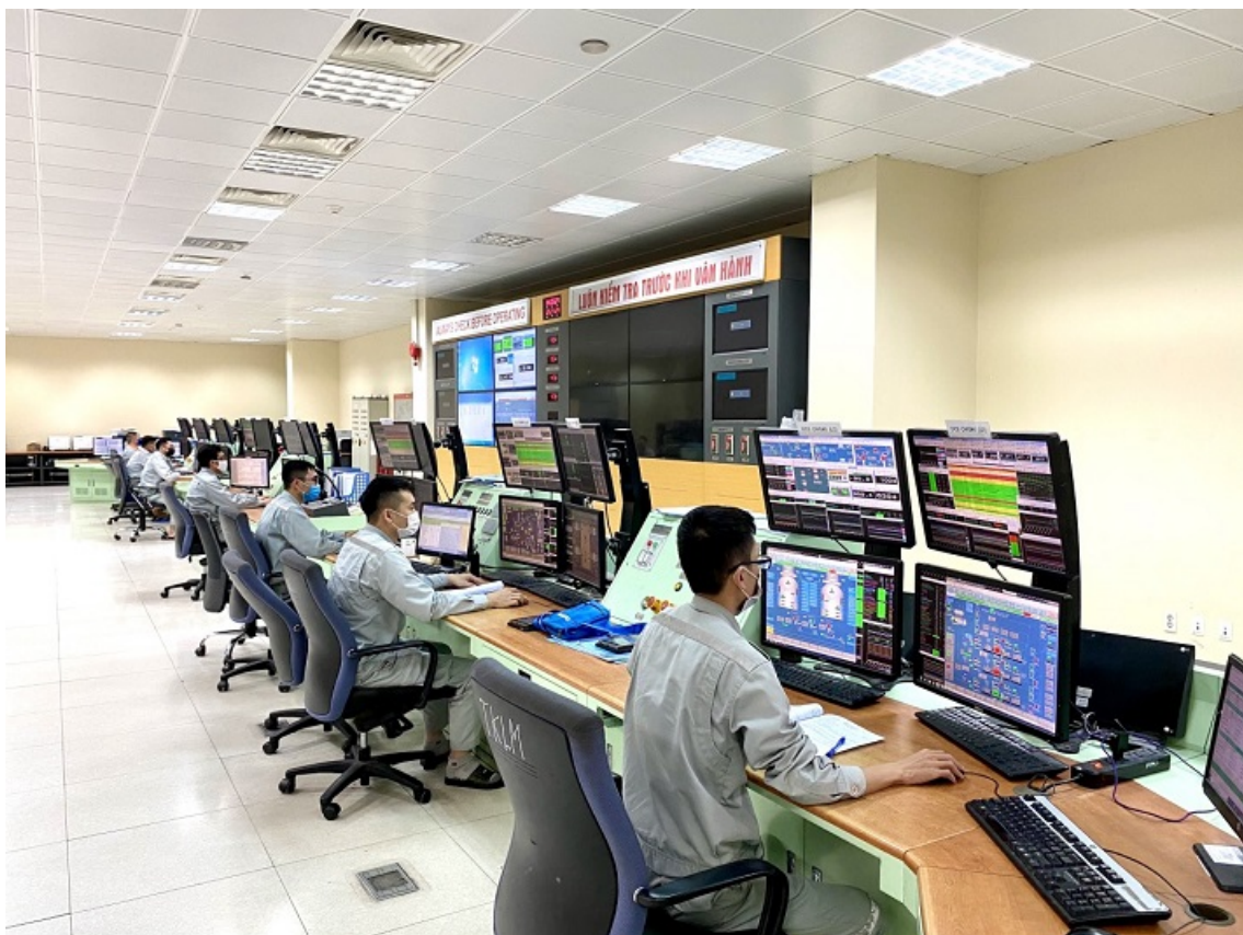
Phòng điều khiển của Nhà máy Nhiệt điện Mông Dương.
