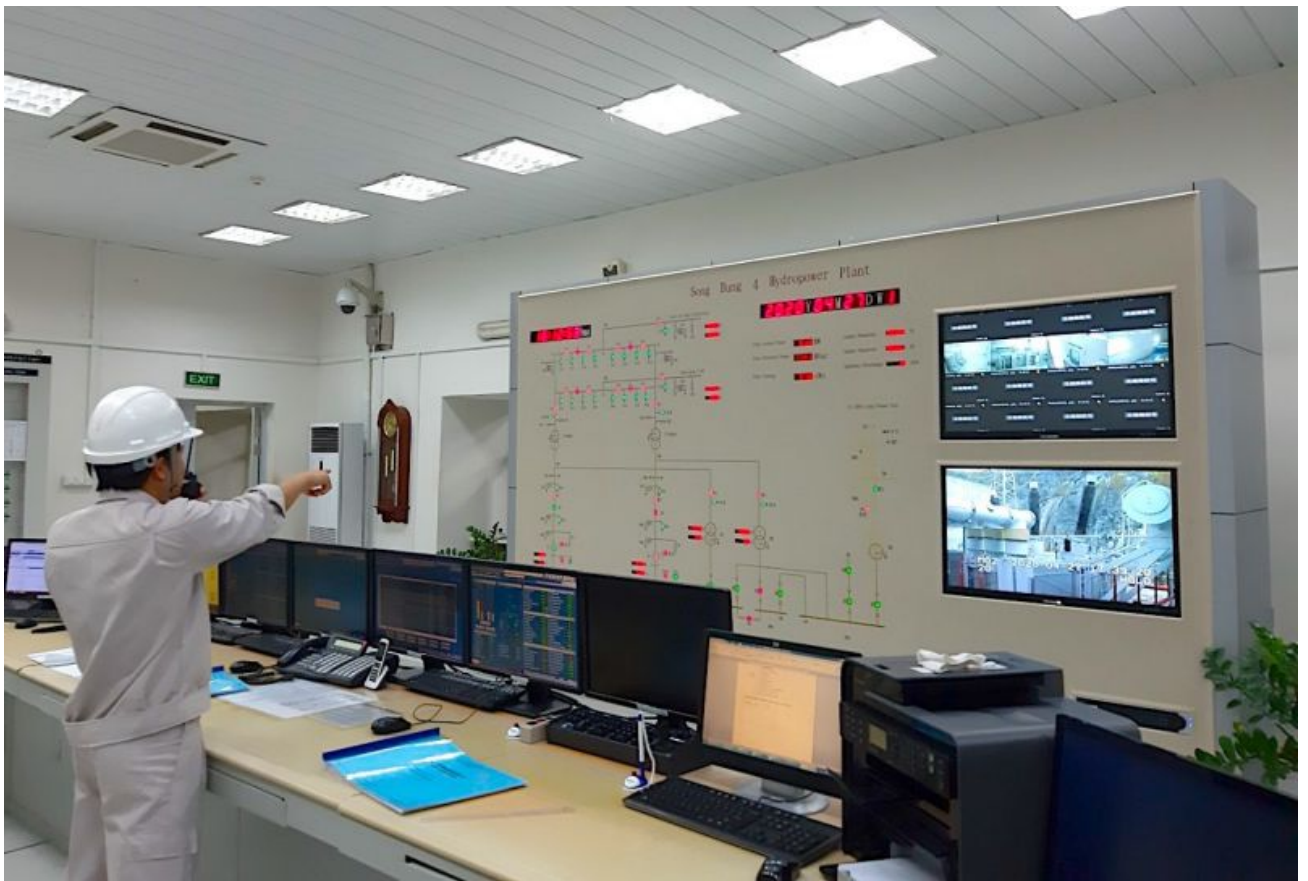
Trực vận hành tại phòng Điều khiển trung tâm nhà máy Thủy điện Sông Bung 4
