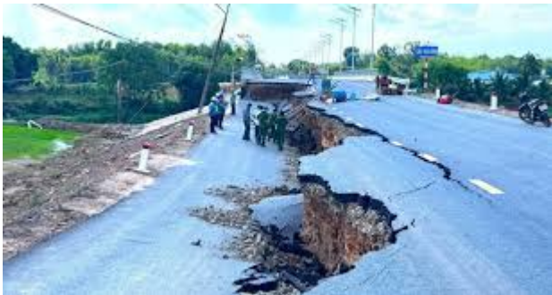
Khẩn trương khắc phục hư hỏng công trình cầu Hòa Bình
