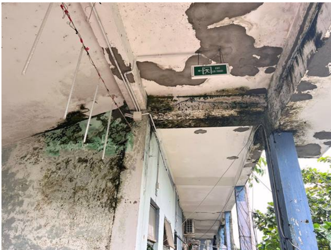
Các bức tường chung cư Hòa Minh mặt tiền đường Trần Anh Tông bị bong tróc, cây cối mọc um tùm.
