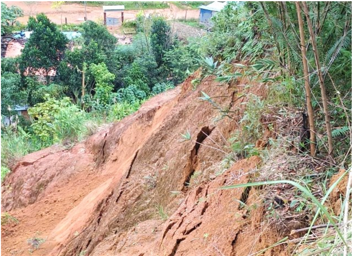
Vết nứt sâu tại thôn Bhlooc đe dọa nhiều hộ dân Cơ Tu.
