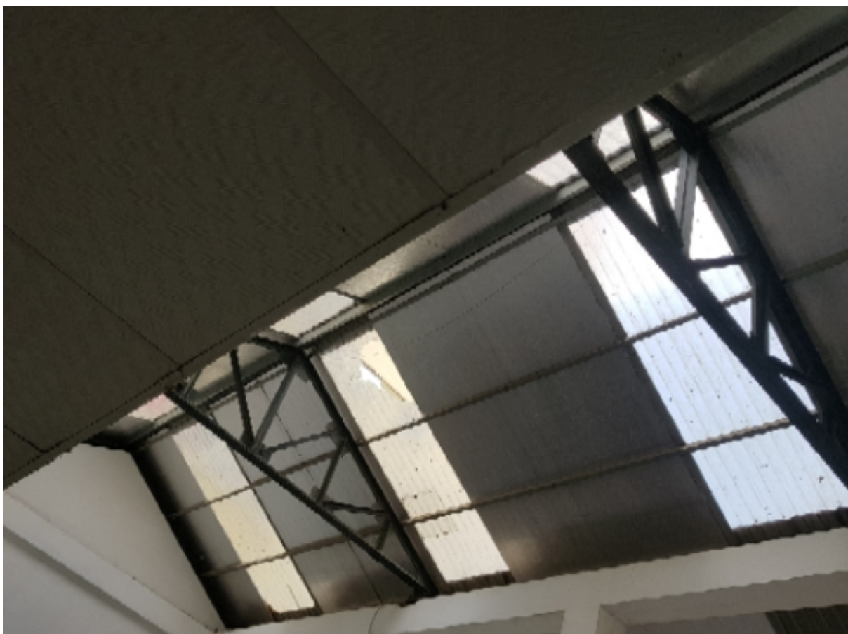
Một số hạng mục của tòa nhà xuống cấp trước khi chủ đầu tư tiến hành khắc phục (Ảnh do người dân cung cấp)
