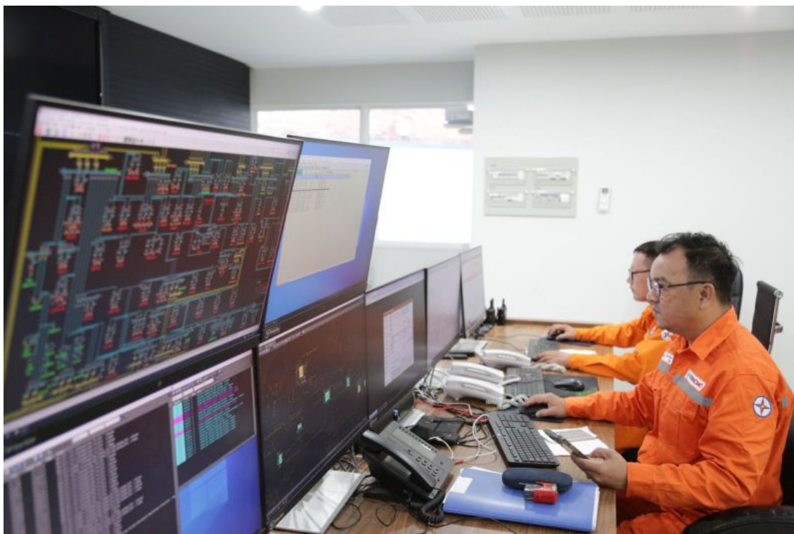
Các đơn vị phân công trực vận hành bảo đảm điện dịp Tết Giáp Thìn 2024 - Ảnh: VGP/Toàn Thắng
