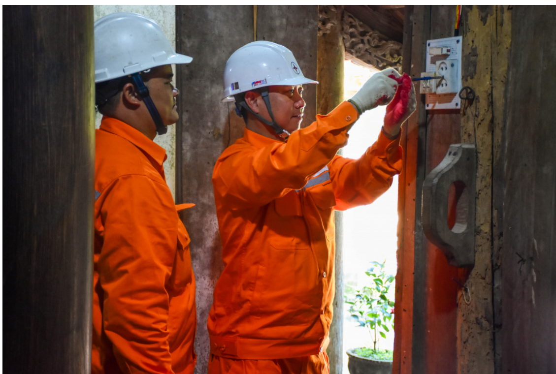
Cán bộ công nhân viên EVNHANOI thực hiện kiểm tra thiết bị điện
