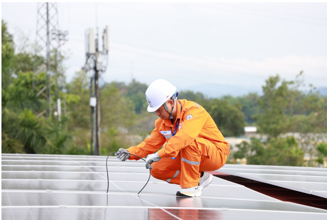
Hệ thống điện mặt trời mái nhà tại trụ sở Điện lực Điện Biên Phủ
