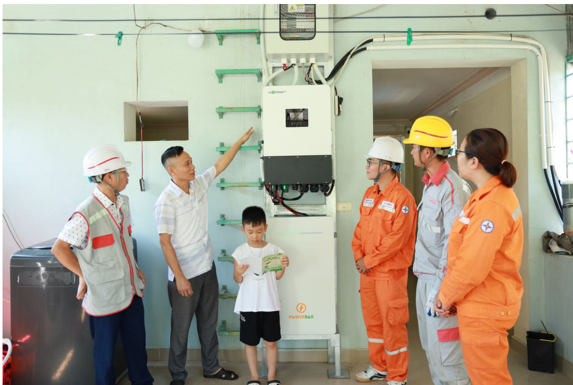
Ông Lê Quý Đoàn, chủ nhà nghỉ Minh Đoàn (thứ 2 từ trái qua) đang giới thiệu về hệ thống điều khiển điện mặt trời mái nhà
