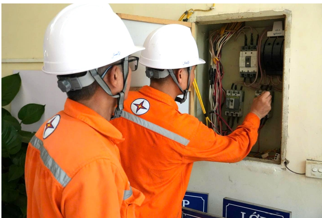
Kiểm tra, rà soát toàn bộ hệ thống lưới điện, trạm biến áp cấp điện cho các điểm thi (Ảnh: Đỗ Hoạt)
