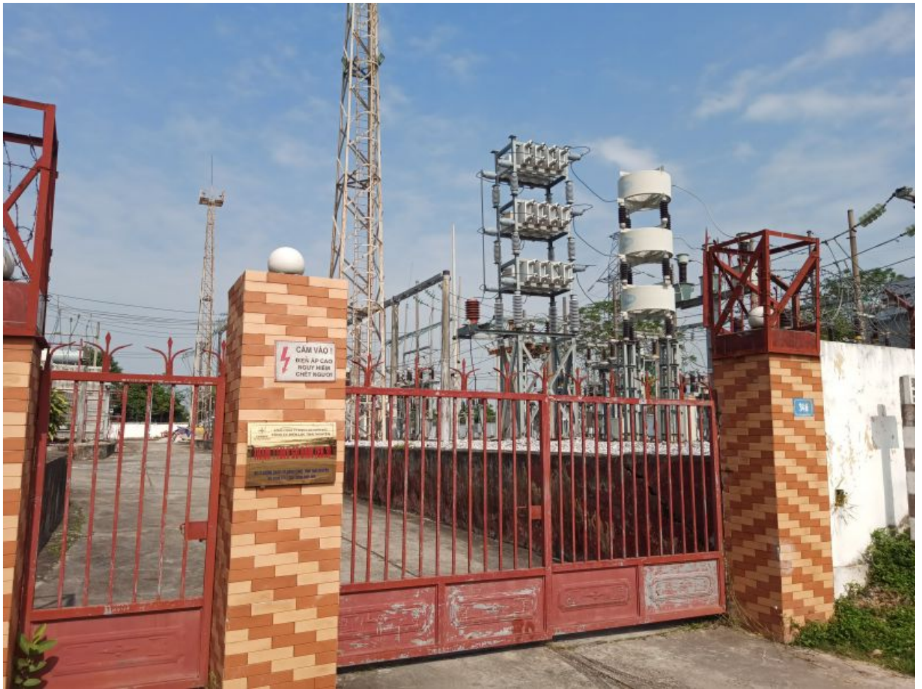
Trạm 110KV Gò Đầm - Phường Lương Châu, T.P Sông Công (Ảnh: Hoàng Thiệp)
