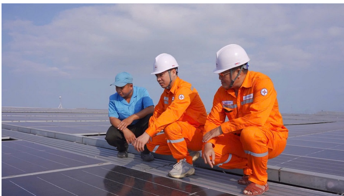
Điện mặt trời mái nhà tại Khu công nghiệp Texhong Hải Hà
