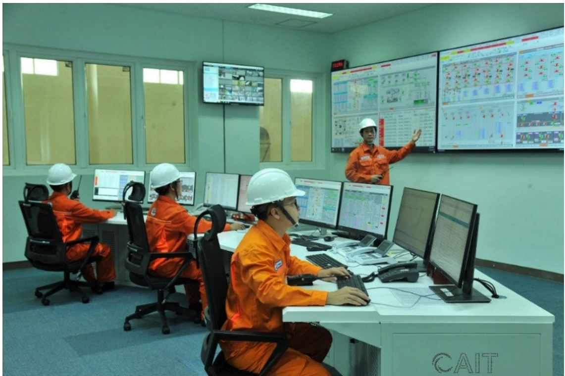
Hệ thống điều khiển, giám sát từ xa Nhà máy Thủy điện Đại Ninh. Ảnh: T.T.
