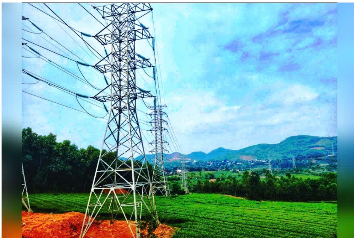
“Xuất tuyến 110kV sau TBA 220kV Phú Thọ 2, tỉnh Phú Thọ”
