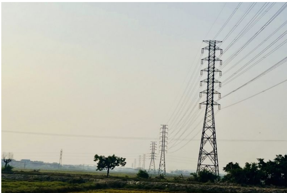
Đường dây 110kV 4 mạch sau TBA 500kV Phố Nối
