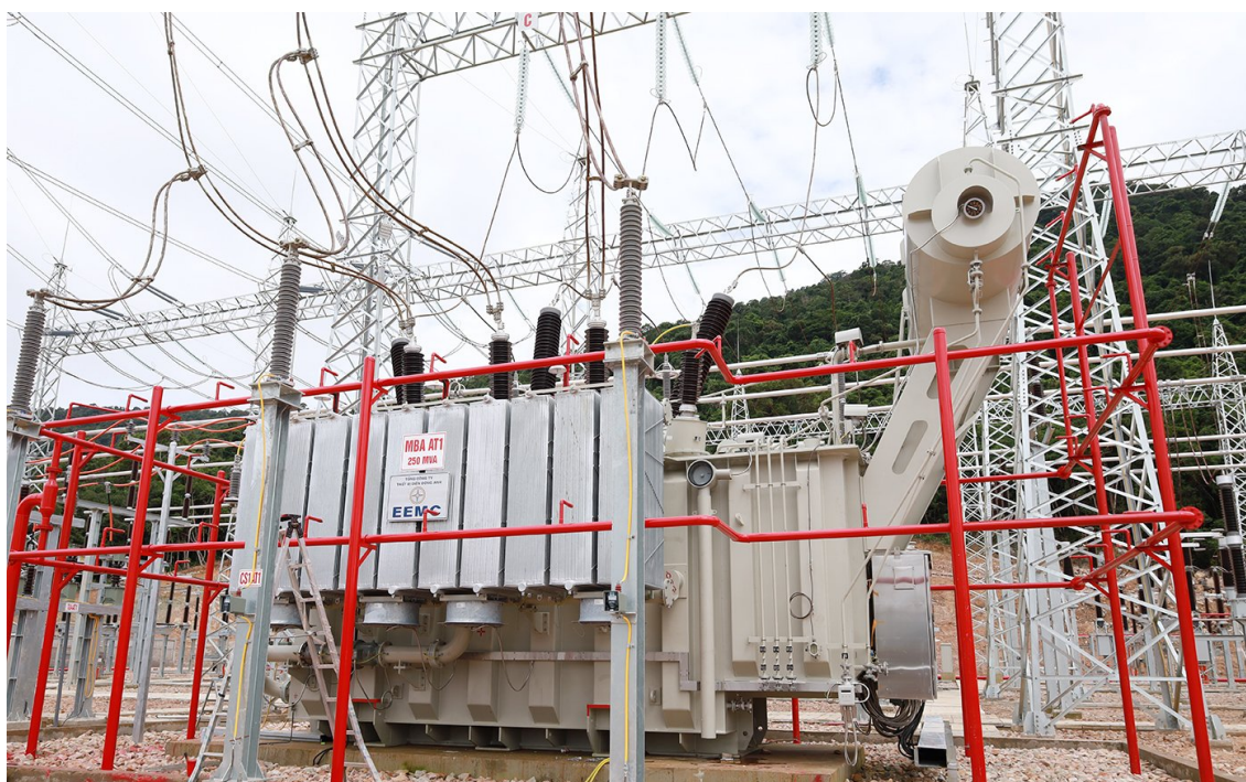
Máy biến áp AT1 220 kV - 250 MVA vận hành tại trạm 220 kV Phú Quốc
