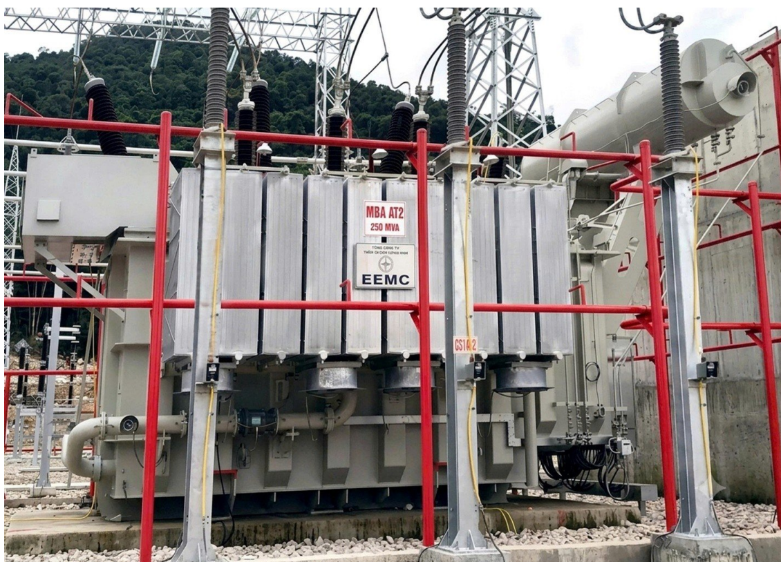
Máy biến áp AT2 220 kV - 250 MVA tại trạm 220 kV Phú Quốc
