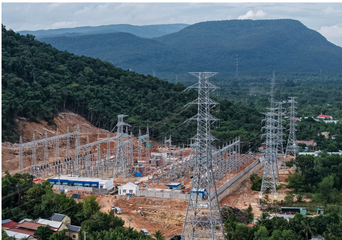
Toàn cảnh trạm biến áp 220 kV Phú Quốc (nguồn: evn.com.vn)
