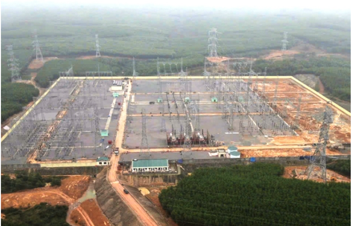
Toàn cảnh Trạm biến áp 500 kV Quảng Trị từ trên cao
